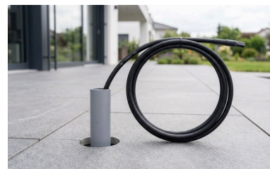
Beispielbild: Zuleitung am Stellplatz, bereit für den Anschluss.
